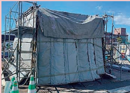
防音対策（型枠加工場）
